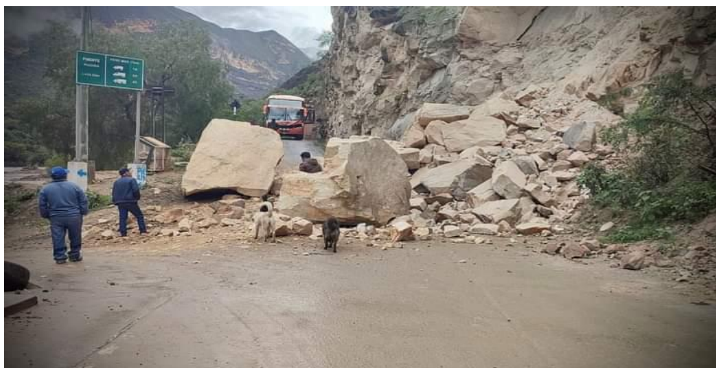
IMAGEN N°05: Derrumbe en el Km 08-00, tramo Huari – Huacaymaba, sector Pushca, Distrito de Uco, Provincia de Huari-
